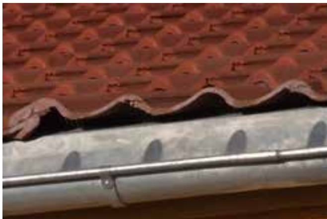
Bild: Dropp från takpannor av betong
